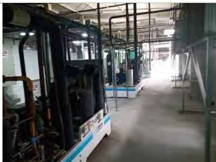
Sala de máquinas
