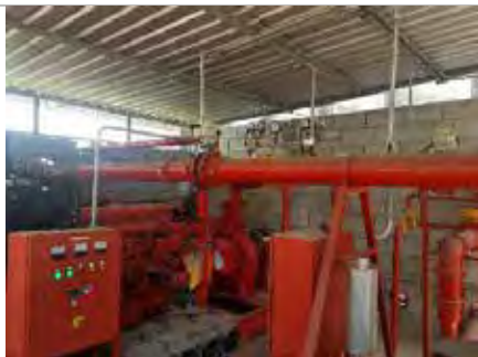
Sala de Bombas
